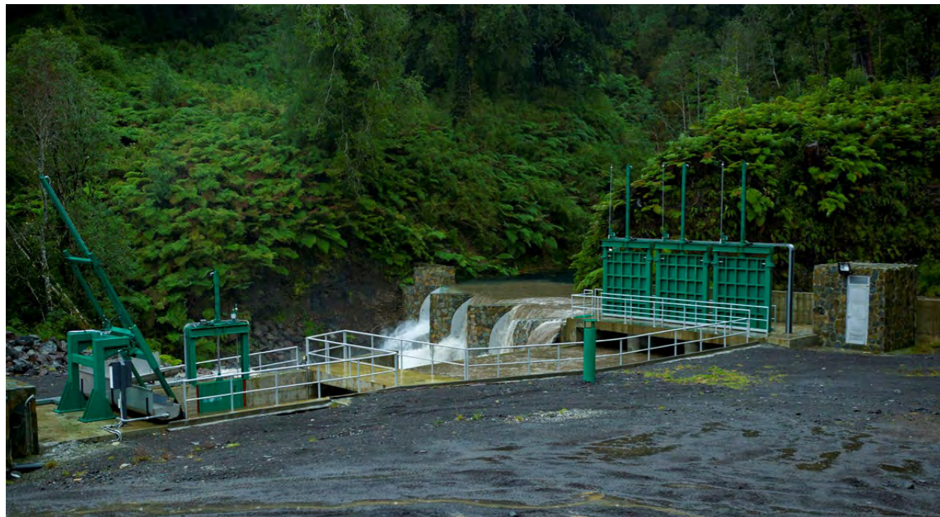
Proyecto de generación de energía sostenible Atacama Hydro (Chile).
